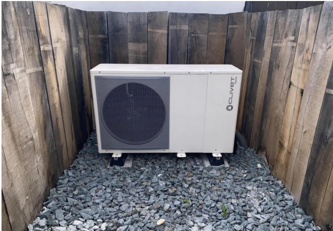
energieeffiziente Luft- Wärmepumpe
