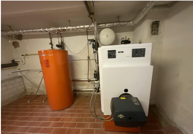
Wohnhaus - KG - Heizung (Brennwertkessel von 2023)
