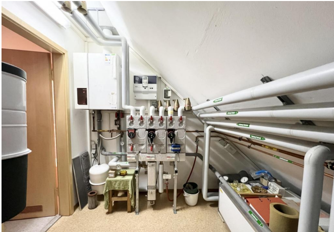
Technikraum mit Heizungsanlage
